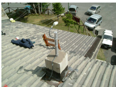
foto 24 – Il supporto ancorato
